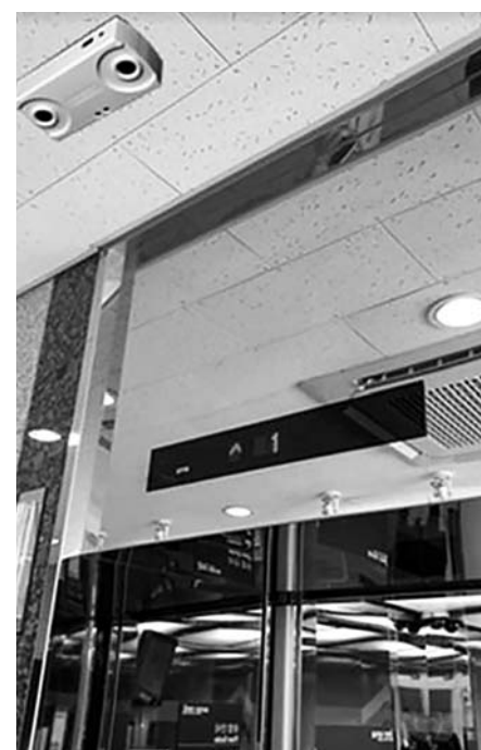
▶울산대교에 설치된 안면인식 무인 계측기
